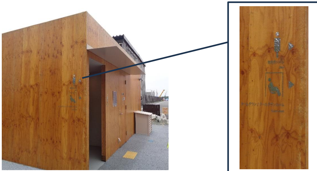
写真 18. 壁に描かれているピクトグラムが見えづらい（休憩所 2 リング北西側）
