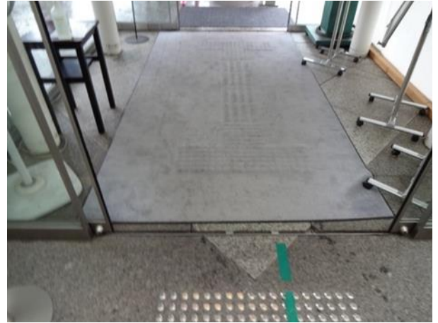
写真 13. 点字ブロックの上に足ふきマットが置かれている：要改善事例 靖国神社（東京）
