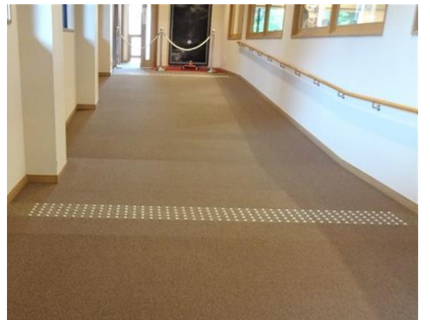
写真 11. 靴を脱いで上がる館内に屋外用の点 字ブロックを設置している 1： 要改善事例 三十三間堂（京都）
