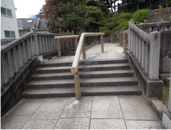
写真 22. 階段の手すり：要改善事例 泉岳寺（東京）
