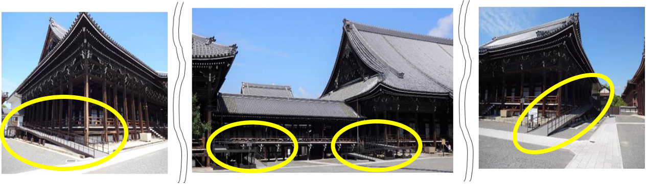
写真 5. 景観に配慮したスロープ：要改善事例 西本願寺（京都）
