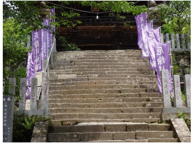
写真 19. 階段の手すり：要改善事例 筑波山神社（茨城）
