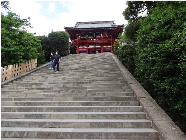
写真 14. 階段の手すり：要改善事例 鶴岡八幡宮（神奈川）
