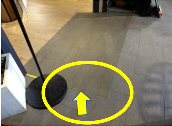
写真 12. スロープを設置したために、側面に段差ができてしまったが、路面に色の違いがないために、弱視者にとっては段差があることに気がつかず、つまずくことになる
